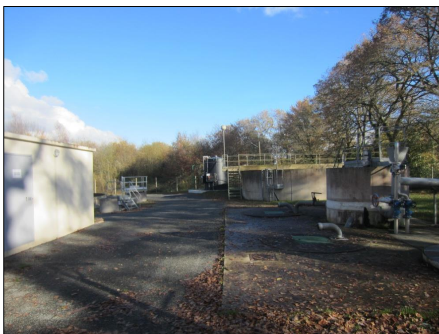
Photo 1 : Station d'épuration du secteur aggloméré de Bains-sur-Oust
